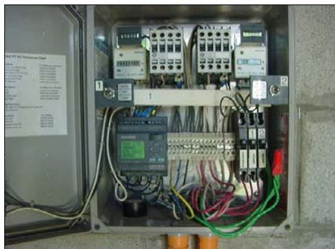
Foto 3-9: Panel de control para las bombas en una de las PTARs de Puerto Barrios, Guatemala.
