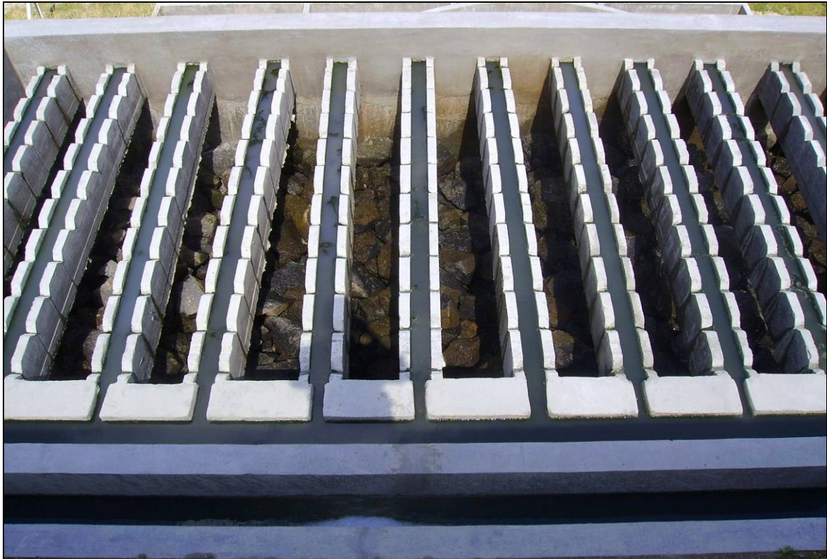
Vista superior de un filtro percolador, se observan las canaletas distribuidoras de caudal.
