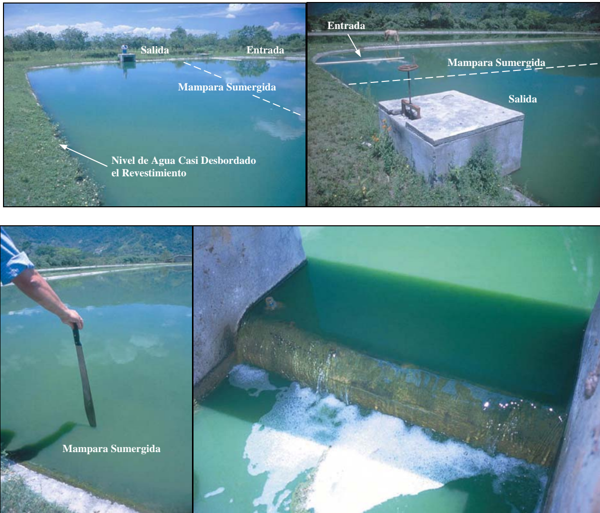
Fotos 5-14: Un ejemplo del mal diseño de los dispositivos de salida, especialmente el vertedero de la salida, en una laguna de maduración. El nivel del agua está casi desbordando el revestimiento de la laguna, y la mampara desviadora está sumergida. Como resultado, existe un corto circuito hidráulico fuerte que permite al afluente estar dirigido directamente por la salida, lo que niega el volumen entero de la laguna. El vertedero es hecho de concreto y no es ajustable, y está ubicado dentro de una caja de concreto con una tapadera pesada hecha de concreto. El operador no pudo ajustar el nivel de la laguna para poder controlar lo que estaba pasando. Las salidas deben contar con compuertas de fondo ajustables, vertederos ajustables y canales abiertos para la operación y el mantenimiento (Choloma, Honduras).
