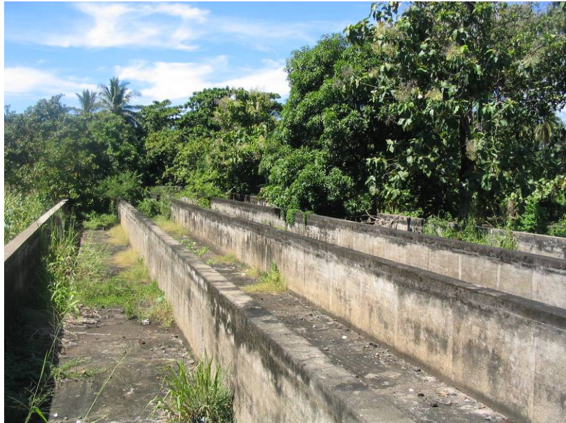
Zanja de Oxidación abandonada, El Salvador.
