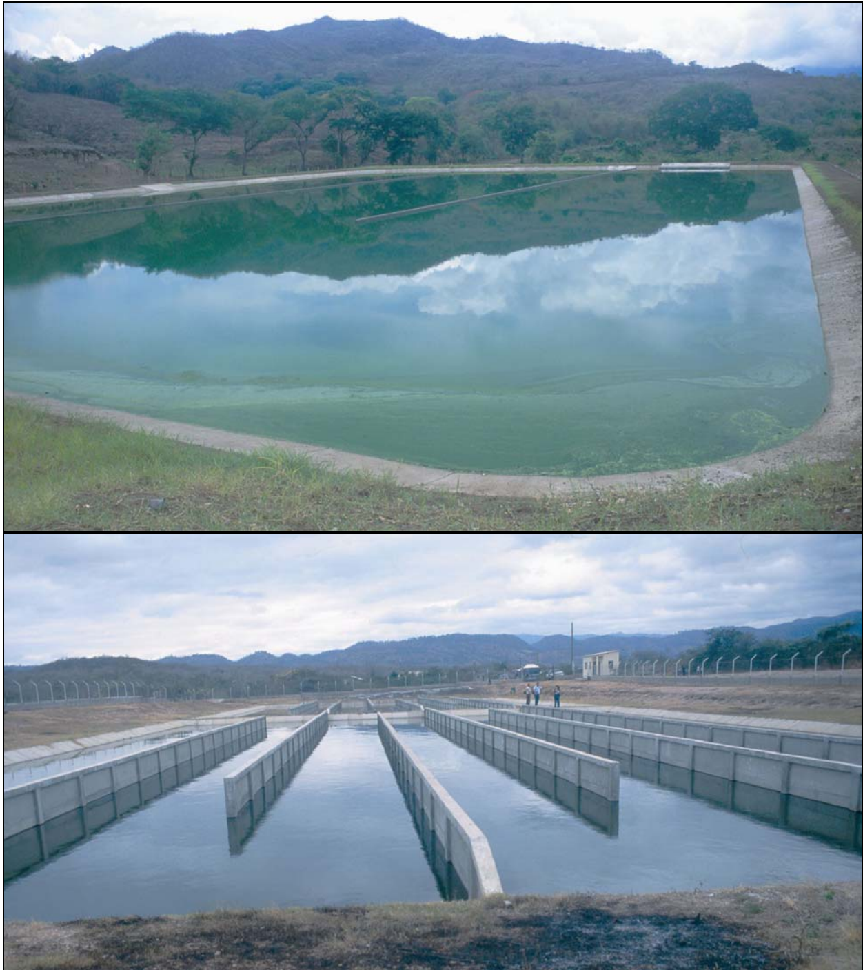
Foto 3-6: Otros ejemplos de lagunas de maduración que están canalizadas con mamparas. En la foto arriba la relación largo/ancho aproxima 20/1, y en la foto abajo 50/1. En la foto de abajo las mamparas están demasiado arriba del nivel del agua y prohíben la insolación solar por la sombra que forman; deben estar más por abajo como en la foto de arriba (Foto arriba: Trinidad, Honduras; abajo: Morocelí, Honduras).
