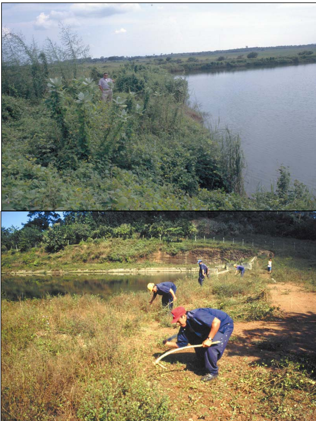
Fotos 6-7: En la foto de arriba (Choluteca, Honduras) la laguna facultativa tiene problemas serios con el sobrecrecimiento de la maleza en la corona del terraplén y en la orilla. (Nótese el hombre en el centro de la foto). Es un trabajo fundamental del operador para controlar el crecimiento de la maleza como se ve en la foto de abajo donde una brigada de personal de la Administración Nacional de Acueductos y Alcantarillados (ANDA) de El Salvador corta las malezas en el terraplén de la laguna facultativa (Zaragoza, El Salvador).
