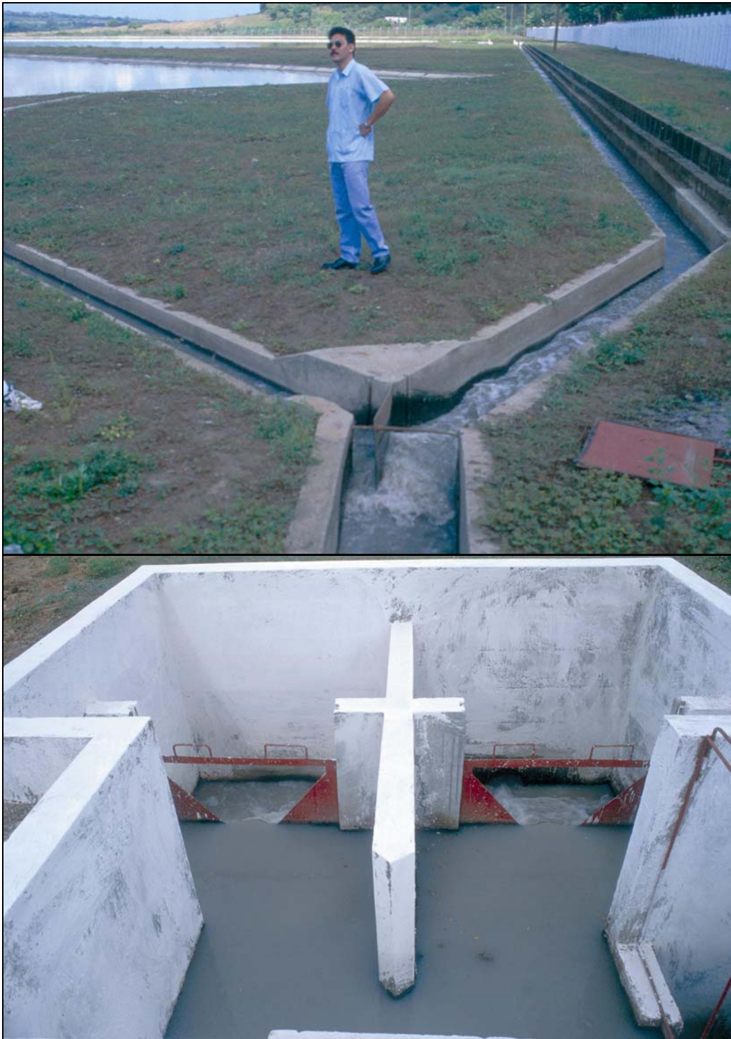
Fotos 5-12: Ejemplos de dispositivos para la repartición de caudales entre baterías de lagunas facultativas en paralelo. En la foto de arriba (Masaya, Nicaragua), se utiliza un tabique divisorio ajustable, y en la foto de abajo (Granada, Nicaragua), un tabique divisorio combinado con vertederos triangulares ajustables. Se debe medir los caudales de cada laguna para estar seguro de la repartición.
