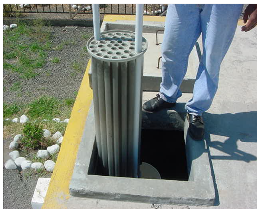
Foto 3-5: Filtro Biotubo grande en el punto de descarga de un tanque séptico (10,000 galones de capacidad (38 m 3 )) en La Unión, El Salvador.
