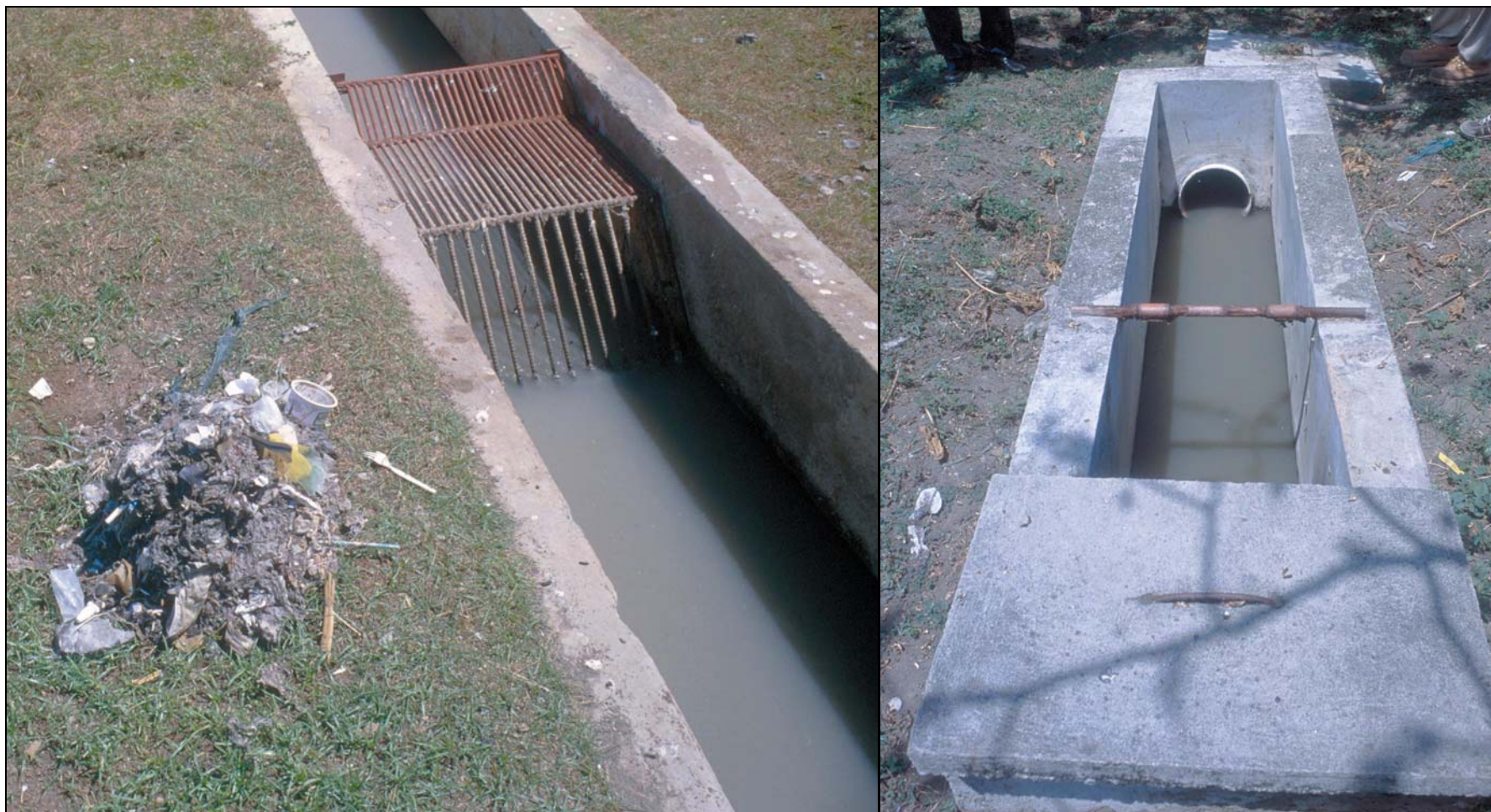
Fotos 7: La rejilla a la izquierda, mientras que tiene una abertura apropiada para que retenga los sólidos más gruesos y que permita pasar las heces humanas, y también una plataforma de drenaje adecuada, no debe ser construida de barras de refuerzo. Las barras de refuerzo, por la calidad del metal utilizado en su construcción, no duran por muchos años en un sistema de aguas residuales donde se favorece las condiciones de corrosión. Los sólidos en la foto izquierda deben ser enterrados inmediatamente para proteger la salud pública (Izquierda: Granada, Nicaragua; Derecha: Choloma, Honduras).
