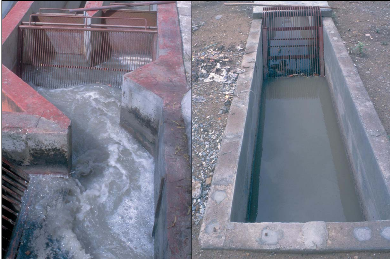
Fotos 8: Los canales de aproximación antes de la rejilla deben tener una velocidad de 0.45 m/s para que los sólidos arenosos no sedimenten, y la velocidad a través de las barras no exceda 0.6 m/s. También los canales deben tener un tiempo de retención hidráulica mínima de 3 segundos y un largo mínimo de 1.35 metros para asegurar una velocidad uniforme a través de las barras. El canal a la izquierda tiene demasiada turbulencia para tener una velocidad uniforme. El canal a la derecha tiene suficiente largo para asegurar una velocidad uniforme sin turbulencia (Foto izquierda: Urbanización en la Ciudad de Guatemala; Foto derecha: Trinidad, Honduras).
