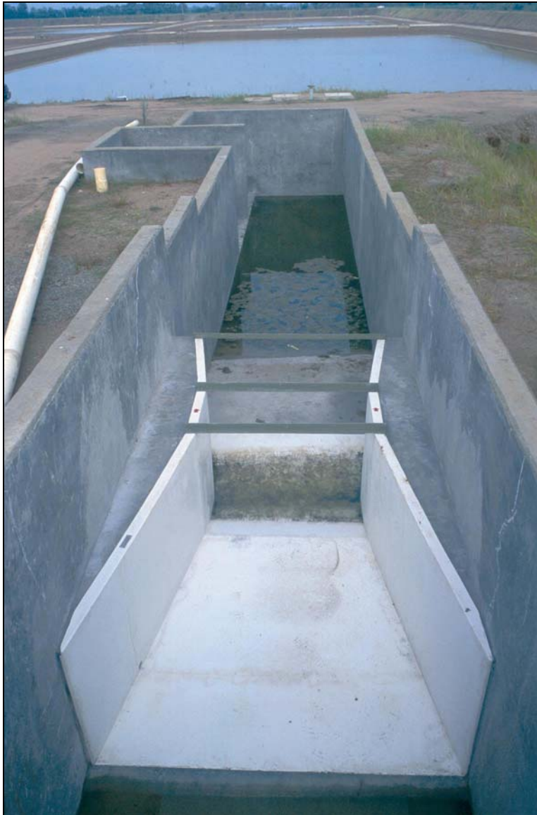
Foto 5-8: Una canaleta Parshall prefabricada, instalada correctamente, debe tener su respectiva lectura de caudal a la vista. La medición de caudales es fundamental para poder determinar la carga hidráulica y orgánica del sistema de lagunas. Un registro de caudales permite la evaluación de la eficiencia del tratamiento, el diagnóstico de una laguna que no funciona bien, la determinación de la magnitud de infiltración y las conexiones legales e ilegales al alcantarillado, y un cálculo aproximado de cuando el sistema de lagunas llegará a su capacidad de carga (El Paraíso, Honduras).
