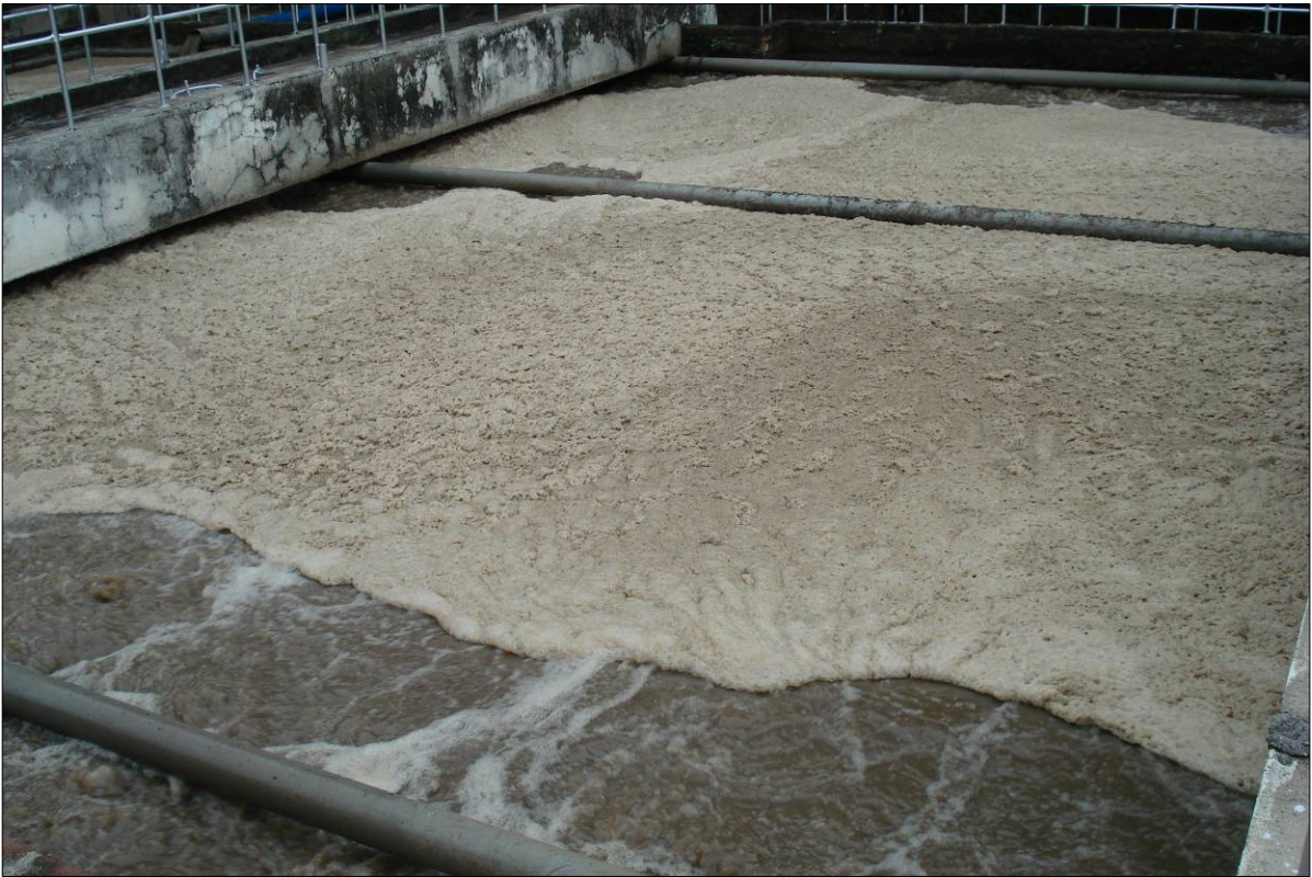
La cubeta de aeración de la planta de tratamiento “Chilama” iniciando funcionamiento.
