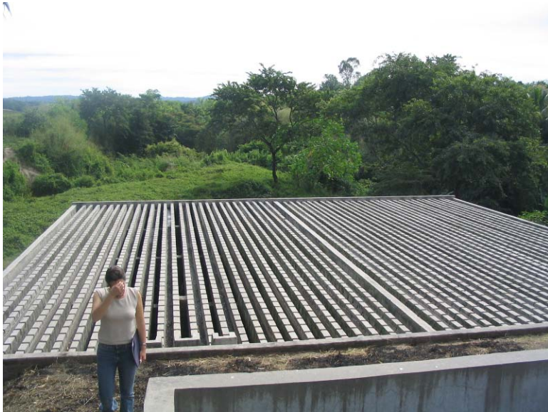
Filtro percolador, El Salvador.
