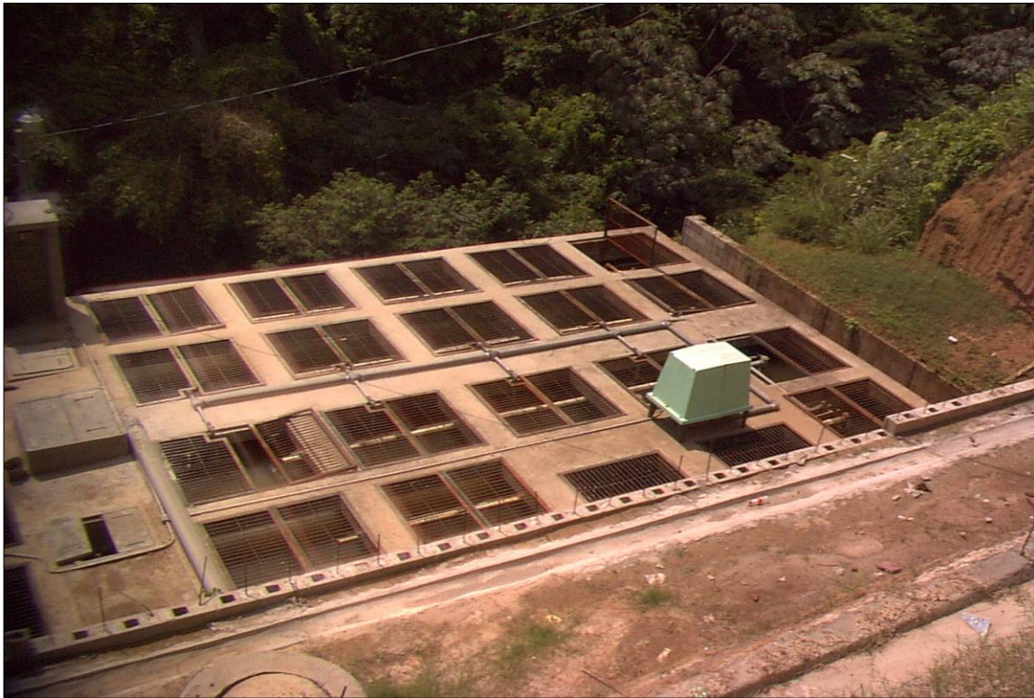
Panorámica de un módulo de planta de tratamiento para aguas negras de lodos activados, modalidad aeración prolongada, construido en Mejicanos para 220 viviendas.
