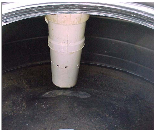
Foto 3-4: Sujetador plástico de un filtro de Biotubo pequeño en un tanque séptico en Puerto Barrios, Guatemala.
