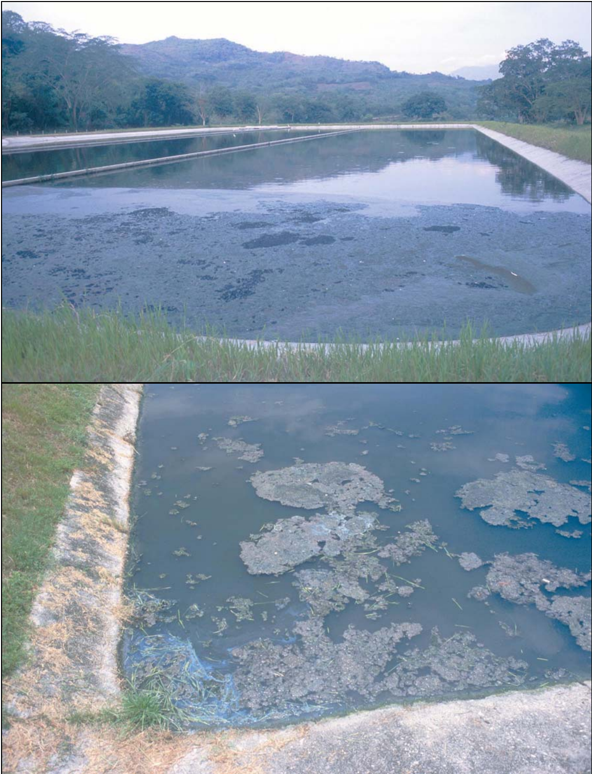
Fotos 6-3: Las natas y los sólidos flotantes usualmente se acumulan en las esquinas de las lagunas, principalmente llevados por el viento. El operador necesita de un desnatador y una carretilla para la limpieza de dichos sólidos. Si no los saca con frecuencia, las natas causarán malos olores debido a descomposición, y además servirán como un lugar adecuado para la reproducción de insectos. (Arriba: Trinidad, Honduras. Abajo: Villanueva, Honduras)
