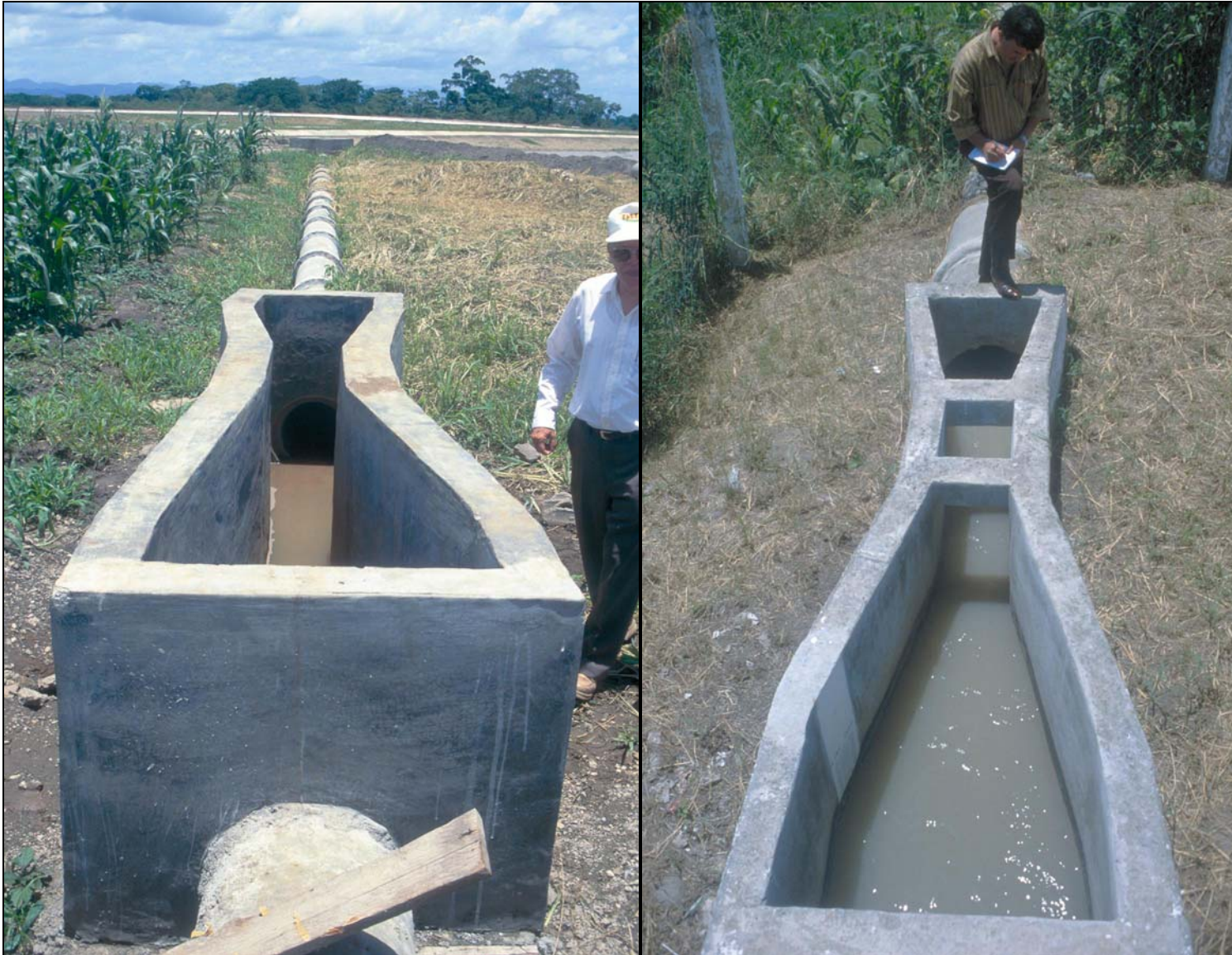
Fotos 12: Ejemplos de canaletas Parshall de concreto que no sirven por su mala construcción (nótense las dimensiones irregulares) y el hecho que no cuentan con flujo libre como se ve en las Fotos 11. Nunca se debe diseñar canaletas Parshall de concreto (Foto izquierda: Catacamas, Honduras; derecha: Villanueva, Honduras).
