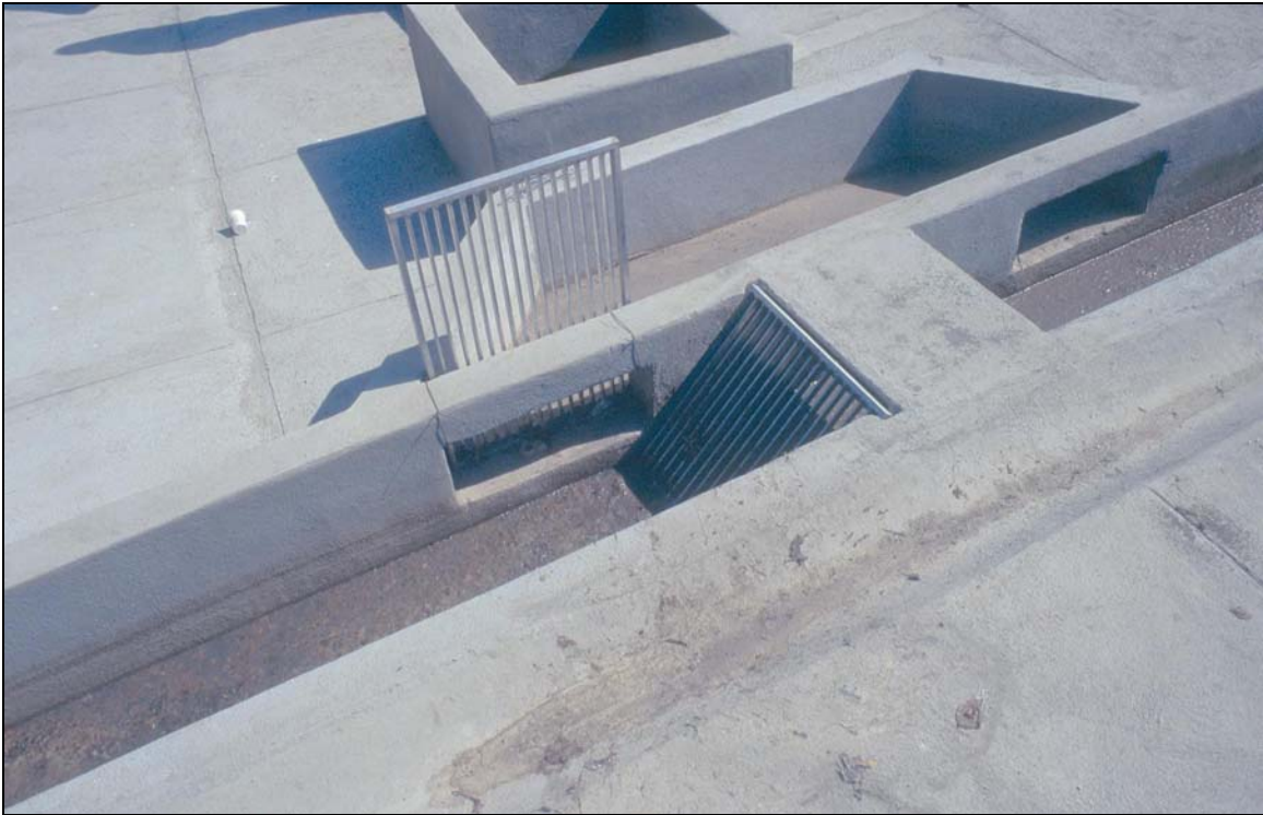
Foto 6: El canal de aproximación antes de la rejilla debe tener una canaleta de desvío como se muestra arriba para desviar el afluente durante una emergencia cuando el operador no está disponible para limpiar la rejilla. Nótese en la foto que las rejillas son hechas de aluminio. La rejilla inclinada debería de haber tenido una plataforma de drenaje de metal (Sanarate, Guatemala).
