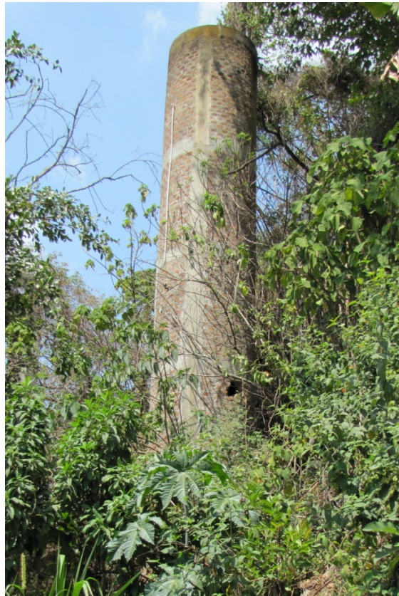
Fotografía 1: Filtro torre experimental de la planta de tratamiento Aurora II.
