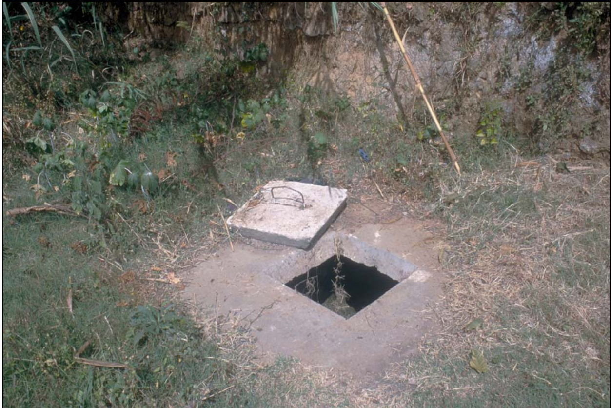
Fotos 14: Los sólidos arenosos siempre estarán contaminados con patógenos y su disposición final requiere una solución sanitaria para proteger la salud de los operadores. En la foto de arriba (León, Nicaragua) la pila de sólidos arenosos debería de haberse enterrado; nótese también la cantidad de material producido que hubiera entrado una laguna primaria sin el desarenador. Una solución adecuada mostrada en la foto de abajo (Urbanización en la Ciudad de Guatemala) es una fosa séptica construida específicamente para la disposición final de los sólidos arenosos.
