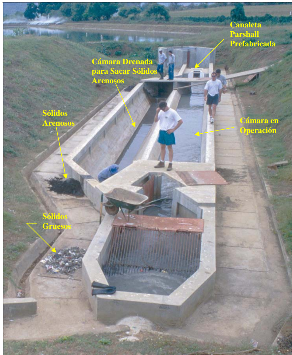
Foto 3: Rejilla y desarenador diseñados para una laguna facultativa, seguidos por una canaleta Parshall prefabricada para controlar el nivel de agua, la velocidad horizontal en el desarenador y medir los caudales. Arriba de la rejilla hay una plataforma de drenaje para drenar los sólidos gruesos removidos con un rastro antes de enterrarlos. El desarenador tiene dos cámaras: se desvía el caudal a una cámara y se drena la otra para sacar los sólidos arenosos. Este desarenador fue instalado porque la carga de arena fue excesiva y la laguna estaba llenando prematuramente con lodos arenosos. Nótese las pilas de los sólidos gruesos y arenosos sacados por el operador y la carretilla utilizada para llevar los sólidos a su lugar de enterramiento (León, Nicaragua).
