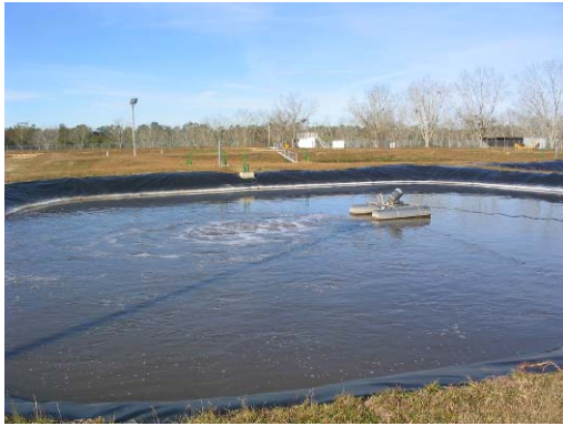
Figura 1. Primera celda de una laguna aireada con aireador flotante, Reservación de Porch Creek, Alabama.
