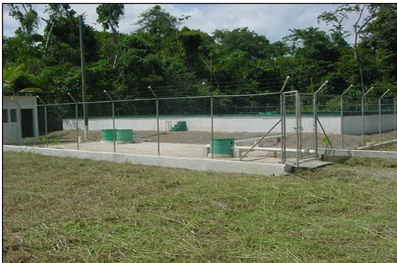
Foto 4-1: Planta piloto de tratamiento de aguas residuales en Livingston, Guatemala.
