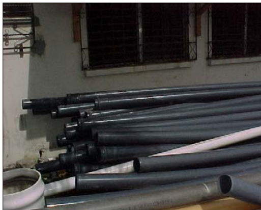
Foto 3-2: Línea de diámetro reducido utilizada en Puerto Barrios, Guatemala.
