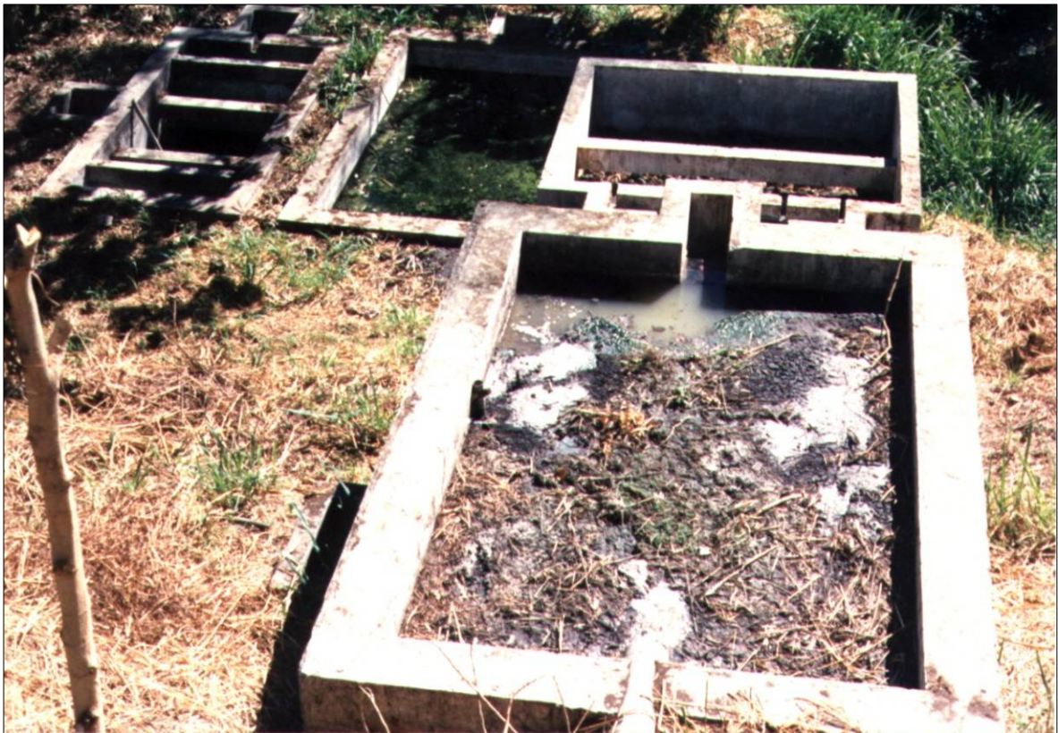
Sistema de tratamiento de la Urbanización El Carmen, Ayutuxtepeque, Depto. de San Salvador Tanque Imhoff y filtro percolador (fuera de funcionamiento).
