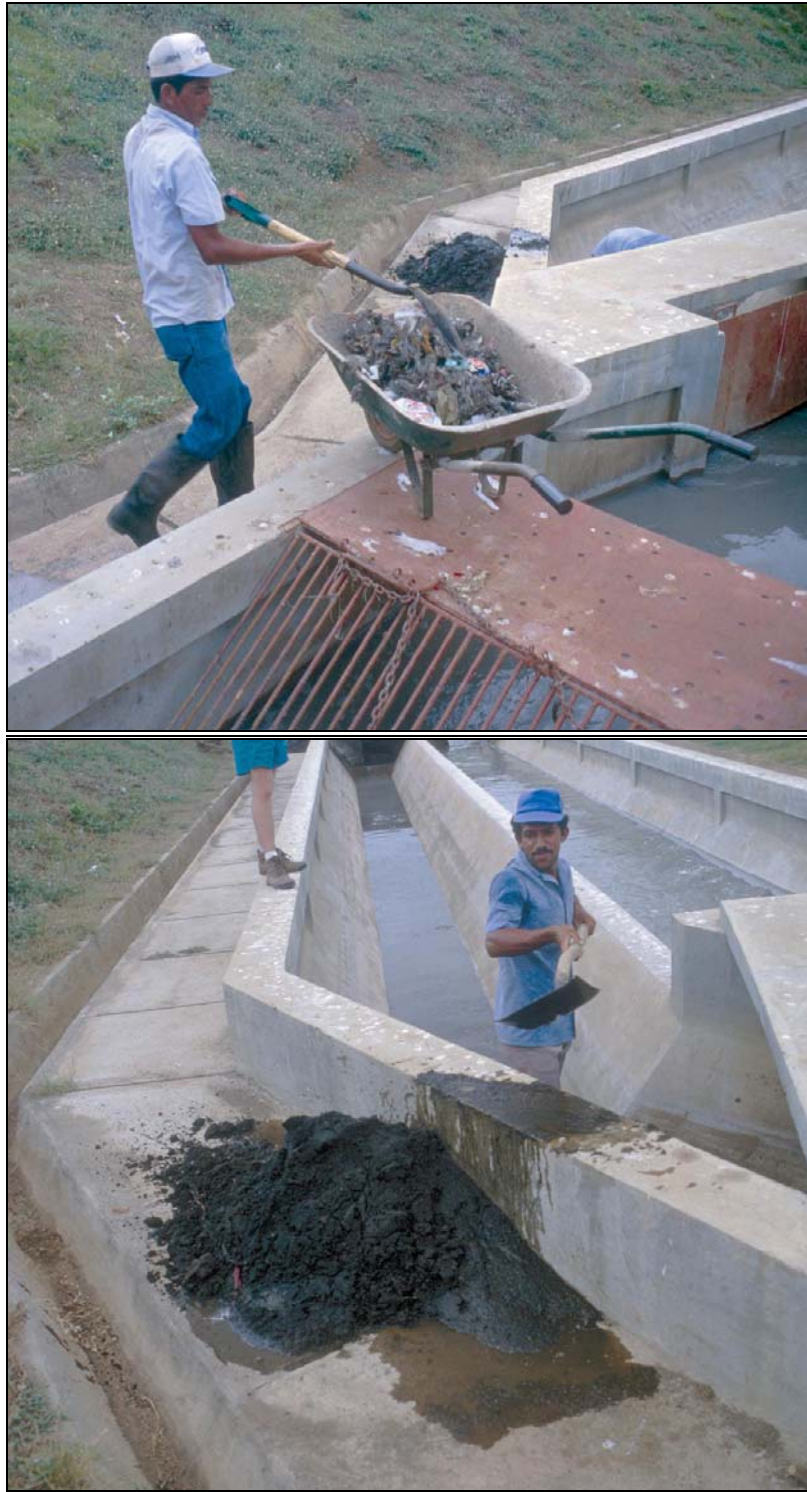
Fotos 6-1: La responsabilidad del operador es limpiar la rejilla diariamente y el desarenador cuando sea necesario, típicamente una vez por semana. Sin embargo, es fundamental agitar los sólidos en el desarenador diariamente para que salgan los sólidos orgánicos a la laguna primaria y para que queden los sólidos inorgánicos en el desarenador. Los sólidos gruesos de la rejilla y los sólidos arenosos del desarenador deben ser enterrados y cubiertos (León, Nicaragua).
