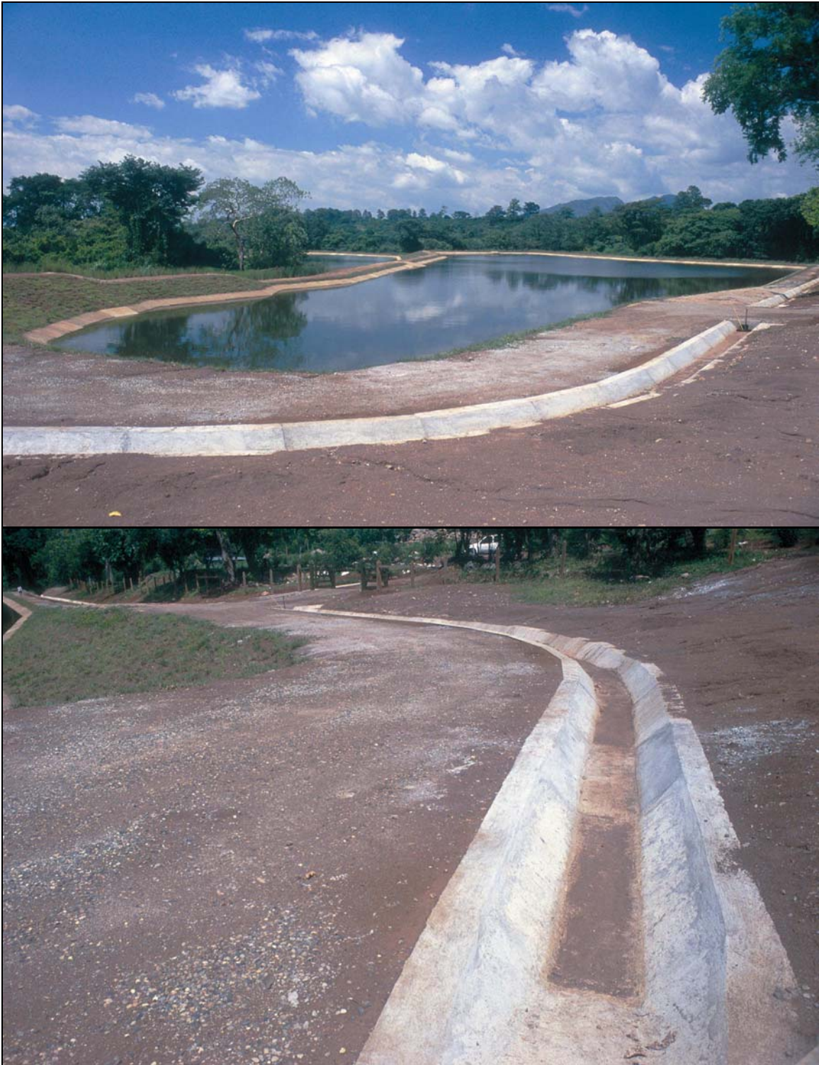
Fotos 5-3: Si la ubicación del sistema de lagunas está aguas abajo del escurrimiento del agua pluvial, se debe utilizar canales para el desvío del escurrimiento para evitar erosión de los taludes interiores (véase la Foto 5-2) y también una carga adicional de sólidos sedimentables llevados por el escurrimiento (Santa Cruz de Yojoa, Honduras).
