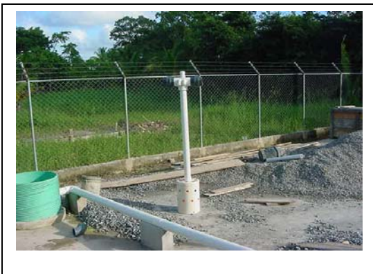
Foto 3-6: Válvula separadora de recirculación en la parte superior y válvula de cierre de flotador de bola en la parte inferior, conectadas por un tubo conector múltiple.
