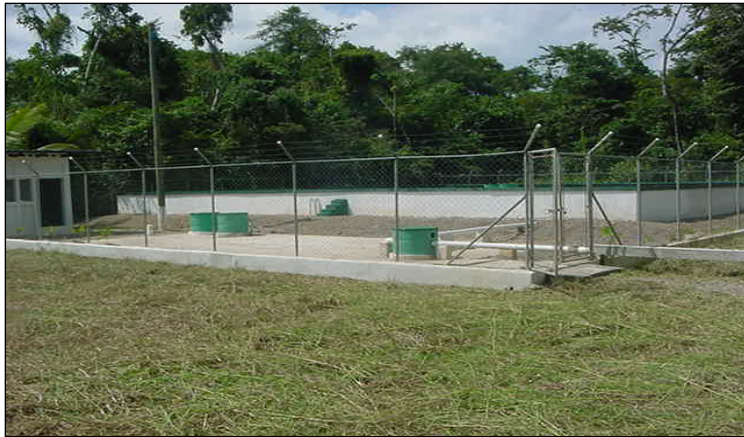
Foto 3-1: Planta piloto de tratamiento de aguas residuales en Livingston, Guatemala.
