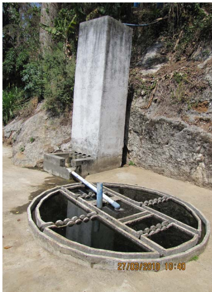
Fotografía 2: Tercer filtro percolador y sedimentador secundario.
