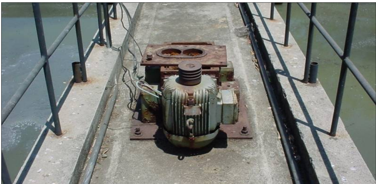
Fotografías mostrando la planta de tratamiento “Chilama” sin funcionar, abajo se puede observar un equipo de aeración deteriorado.
